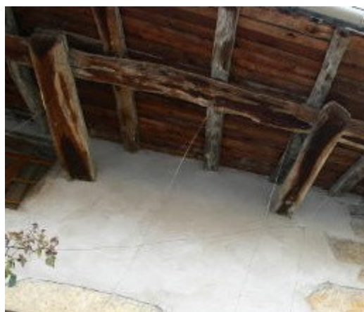
Partie extérieure d'une poutraison de "trabe ramé" d'une couverture de tuiles creuses - Les poutres qui soutiennent l'avancée de toiture sont en équilibre médian sur la maçonnerie. L'effort de basculement est repris à l'autre extrémité par la grosse poutre transversale soutenant la toiture, appelée trabe.
